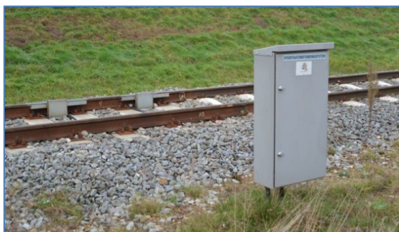
Figuur 11 Spoorstaaf Conditioneringssysteem bij regulier spoor. De kast bevat de regelapparatuur en de voorraad frictieverbeteraar, de elementen bij de rails brengen de frictieverbeteraar bij de rails aan.
